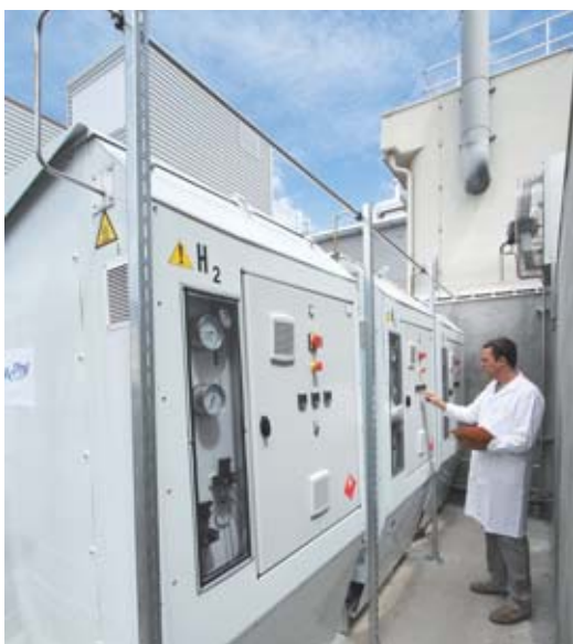
Trois réservoirs de stockage de l'hydrogène, de technologie McPhy Energy, en test à l'Institut Liten/DTBH. Ces réservoirs stockent l'hydrogène dans un hydrure de magnésium (MgH 2 ). Leur particularité réside dans le fait que la chaleur d'hydruration est stockée dans un matériau à changement de phase puis restituée lors de la désorption. Ils permettent chacun de stocker 5 kg d'hydrogène à la pression maximale de 10 bars.
